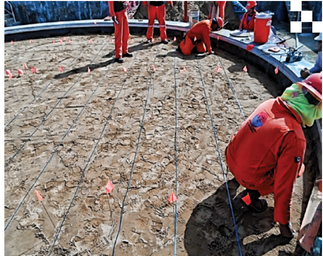
Figura 2. Anillo de concreto y arena como material de relleno para el desplante del soporte del tanque.
