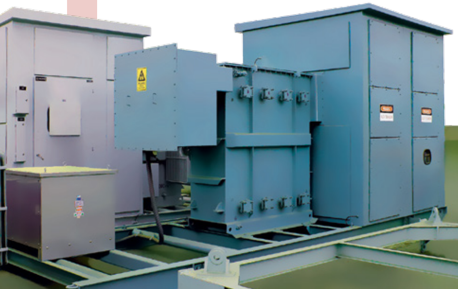
Figura 2. 240 KVA del transformador y el panel de control.
