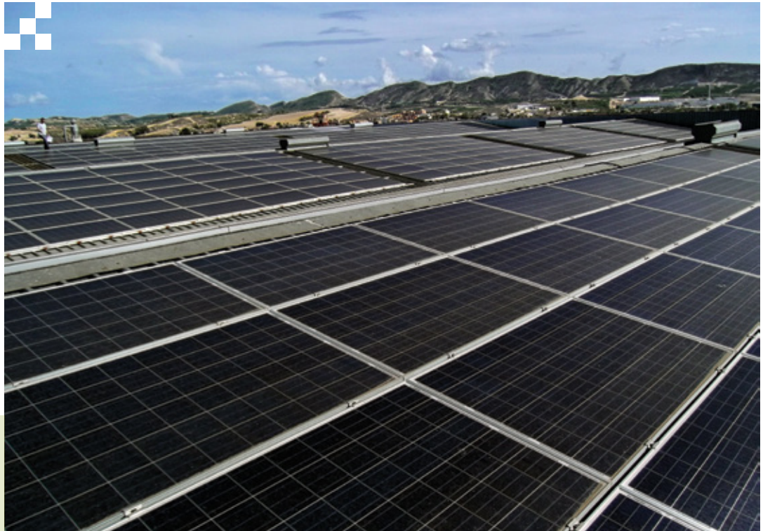
Instalación fotovoltaica sobre cubierta industrial del Proyecto Beniel de la empresa Fotona.
