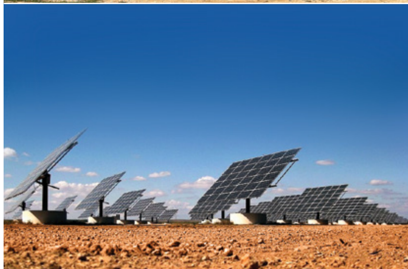
Parque Solar Fotovoltaico con seguimiento a dos ejes. Proyecto PS PEDRERA II FASE 2 de la empresa Fotona.
