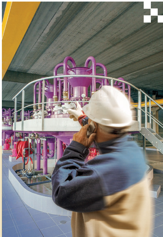
Schneider Electric México proporciona servicios con una solución completa de redes eléctricas inteligentes, que ayudan a mejorar la seguridad, fiabilidad y eficiencia, al tiempo que reduce los costos operativos y de capital.
